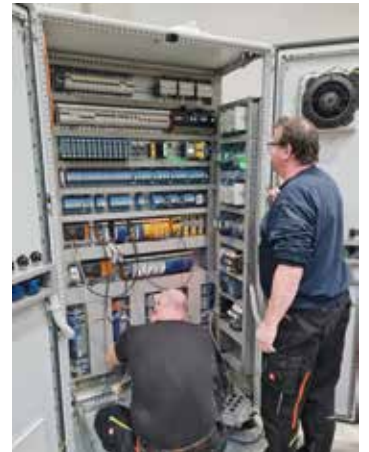
Bis zu 1000 Schaltschränke sollen jährlich in Gersdorf gefertigt werden.
